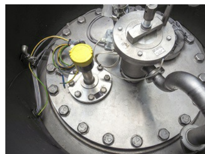
De radarniveausensor VEGAPULS 64 zorgt voor de inhoudsmeting.
