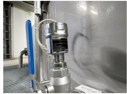
Messstelle mit VEGABAR 82 und „Second Line of Defense“.
