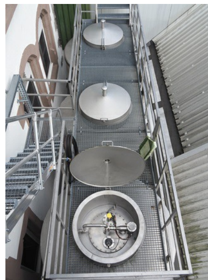
lo strumento di misura di livello radar VEGAPULS 63 installato su uno dei serbatoi di stoccaggio.
