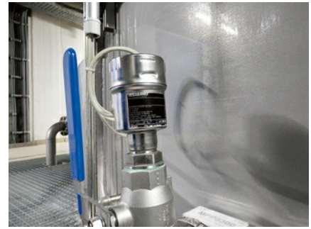
Punto de medición con VEGABAR 82 y «Second Line of Defense».
