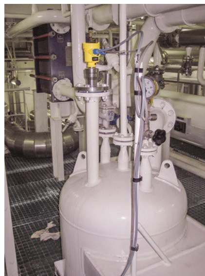
Le VEGAPULS 64 mesure le niveau d'un système de refroidissement à bord d'un méthanier.
