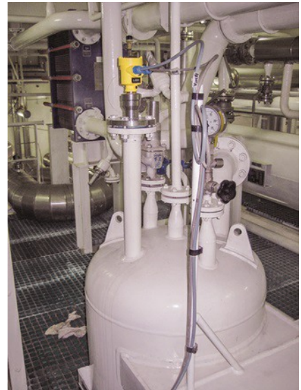
Der VEGAPULS 64 misst den Füllstand in einem Kühlsystem an Bord eines Gastankers.
