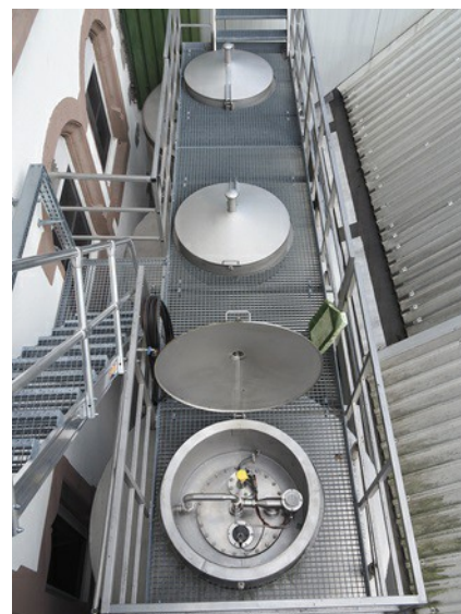
Zicht op de radarniveausensor VEGAPULS 63 op een van de lagertanks.
