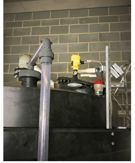
Depolama tankının üzerine monte edilen VEGAPULS 64 radar sensör, tankın içindeki hidroklorik asidin seviyesini tankın tavanından geçerek ölçüyor.
