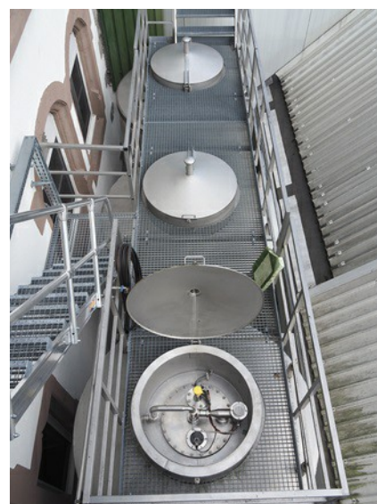
Vista del instrumento de medición de nivel radar VEGAPULS 63 en uno de los depósitos de almacenamiento.
