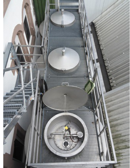
Depolama tanklarından birinin üzerinde bulunan radarlı seviye ölçüm cihazı VEGAPULS 64.
