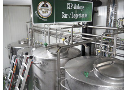
CIP tankında basınç ölçüm transmitterleri kullanılıyor.
